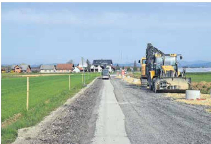
Medtem ko se 'saga' glede mostu nadaljuje, obnova ceste med Križajem in Podbočjem lepo napreduje in bo zaključena do poletja.
