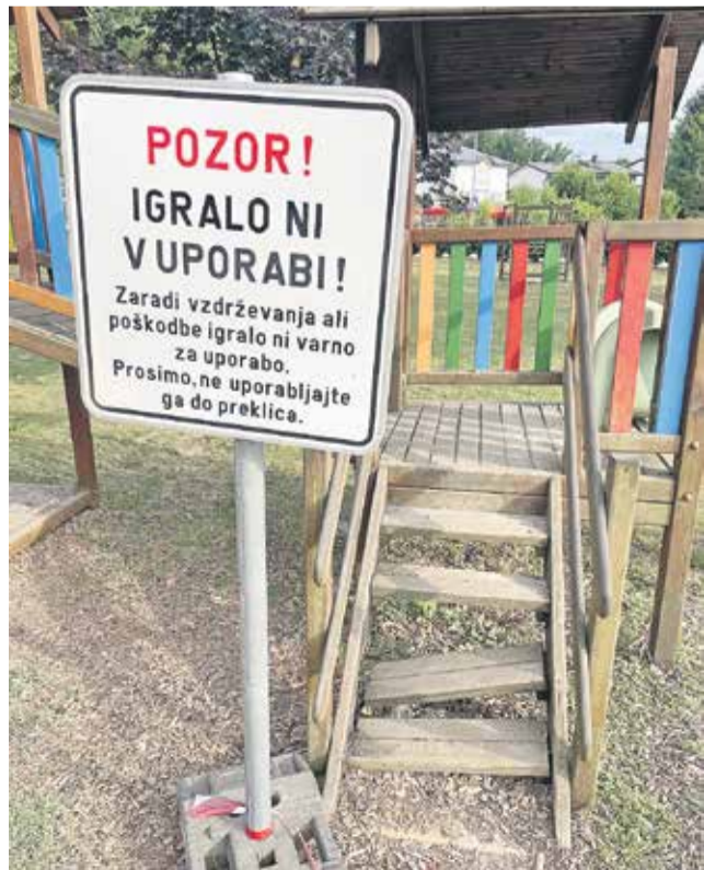
Poškodovano igralo na Ribniku Resa
